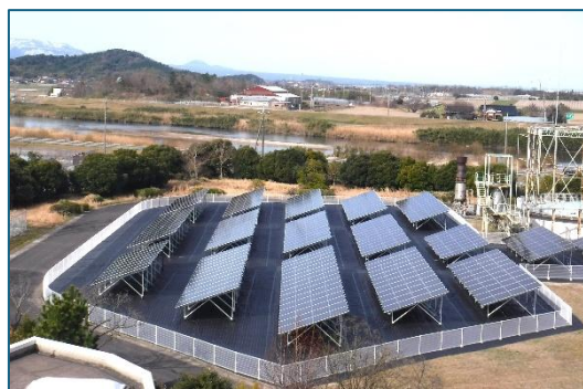
設置されている太陽光パネル(センター西側)
